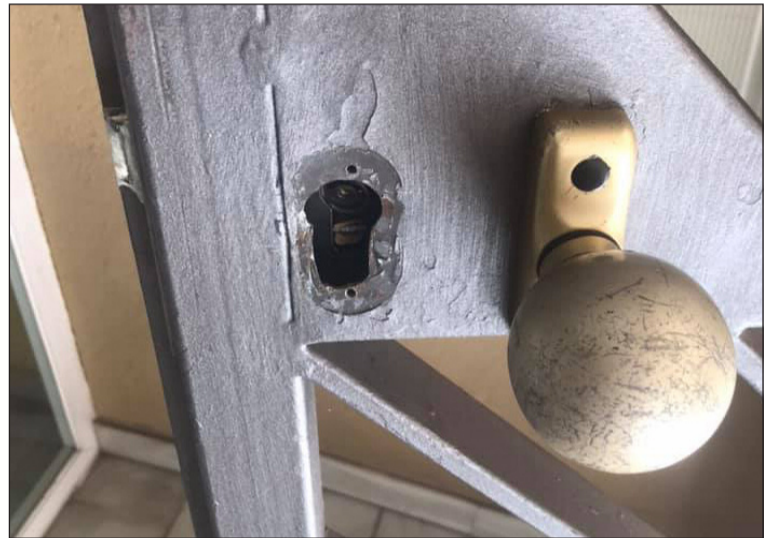
Cerradura de la entrada, destrozada por los ladrones.
